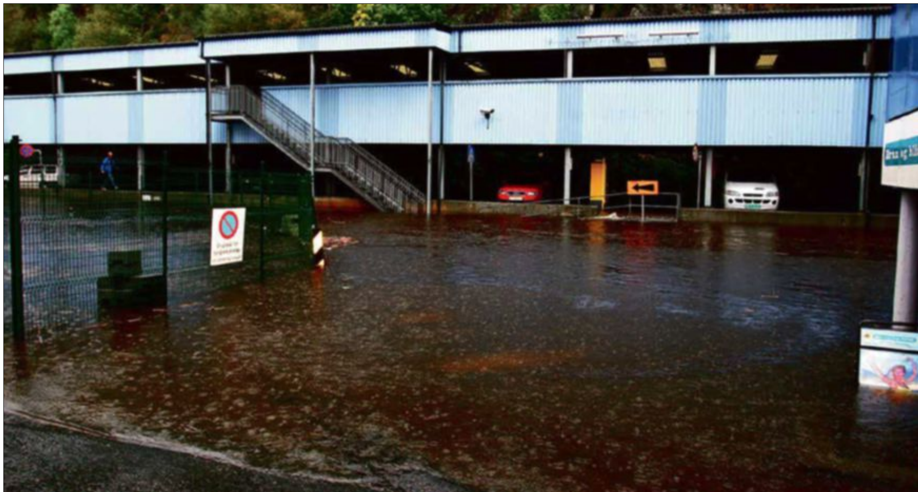
FLOMMET OVER: Vannet flommet over parkeringshuset på Nesttun da storflommen inntraff to ganger i 2005. Helge Drange føler seg sikker på at det kommer til å bli enda verre i fremtiden.
