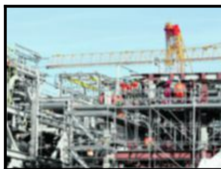
GASS TIL ENGLAND: Her fra gassanlegget på Nyhamna i Aukra i Møre og Romsdal skal Norge forsyne Storbritannia med gass. Anlegget har kostet en milliard kroner.
