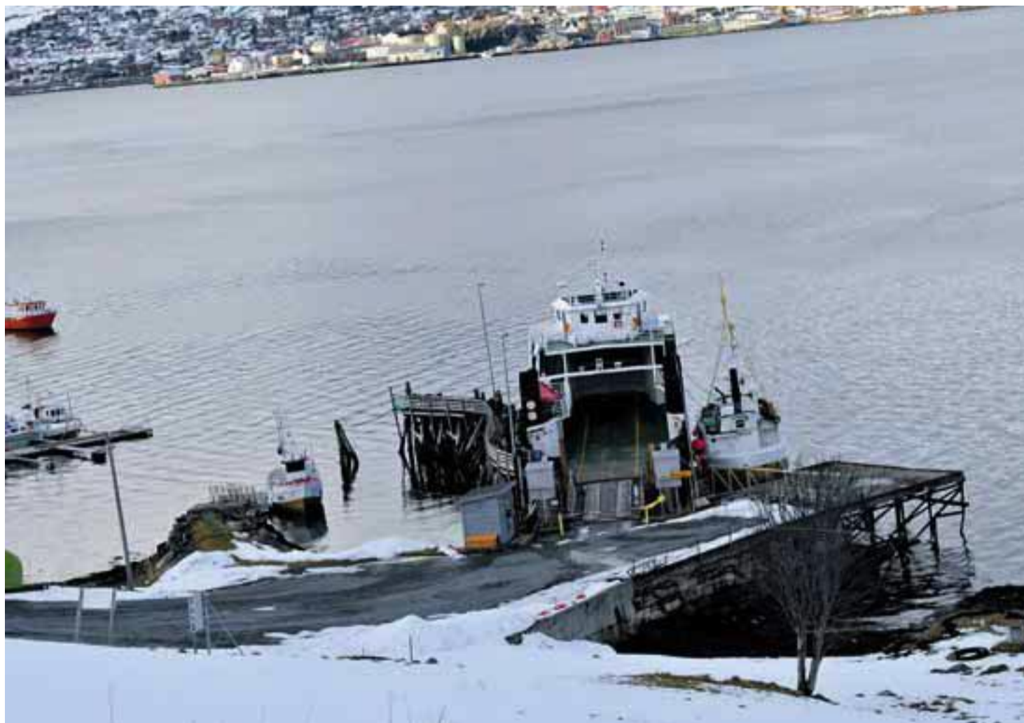
RIVES: Fortsatt ligger Kveøyferga ved kai på den grønne øya. Men snart skal det gamle fergeleiet rives og fjernes. Foto: Kjell Solbakken
