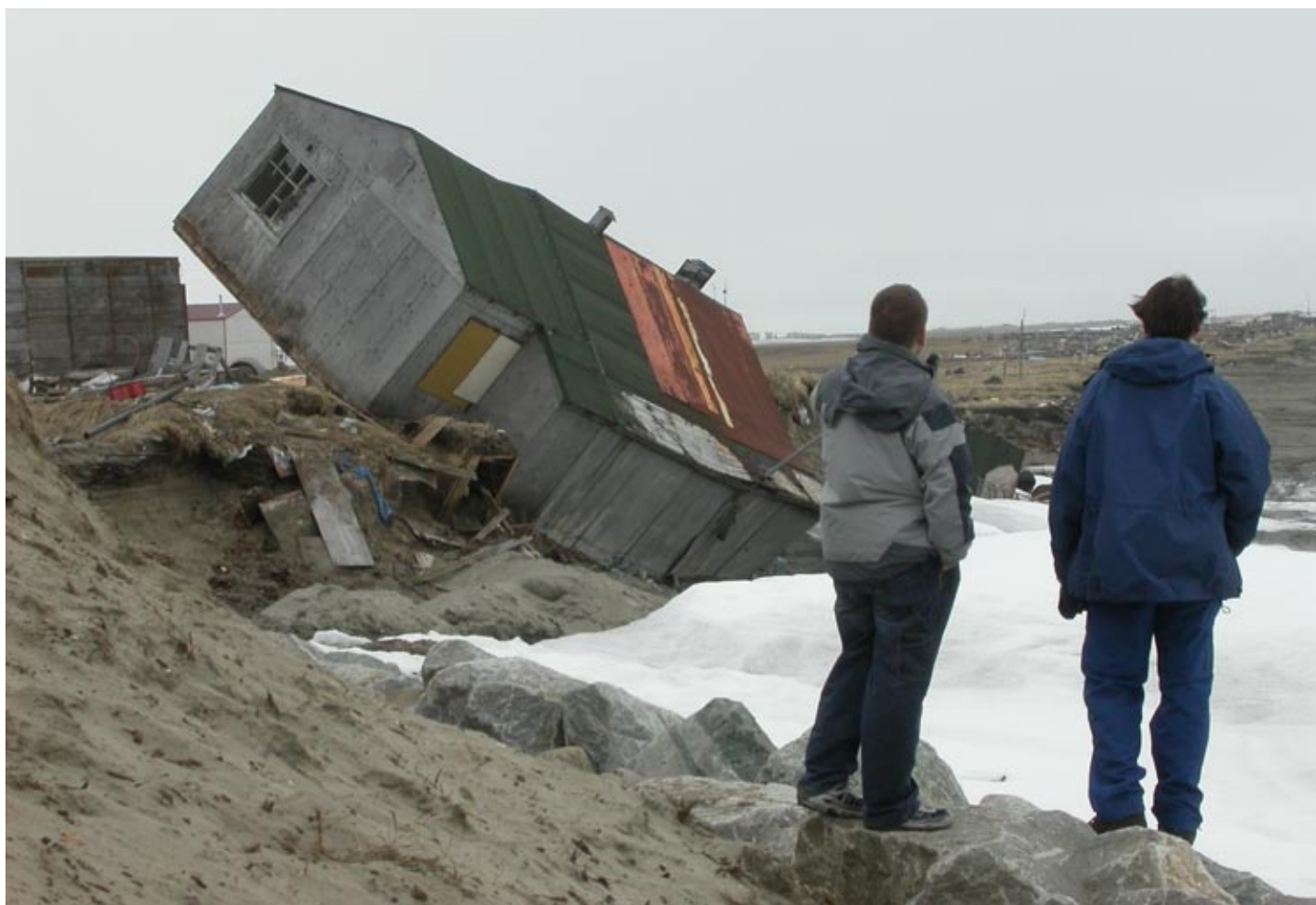
PERMAFROST TINER: Alaska er ein ung stat og det meste av utbygging og utvikling rundt kysten er ikkje meir enn nokre titals år gammal. Her eit øydelagd hus i eskimolandsbyen Shishmaref der permafrosten tiner. Enkelte stader i Alaska har permafrosten felle med fem meter. Foto: Shishmaref Alaska Erosion & Relocation Coalition
